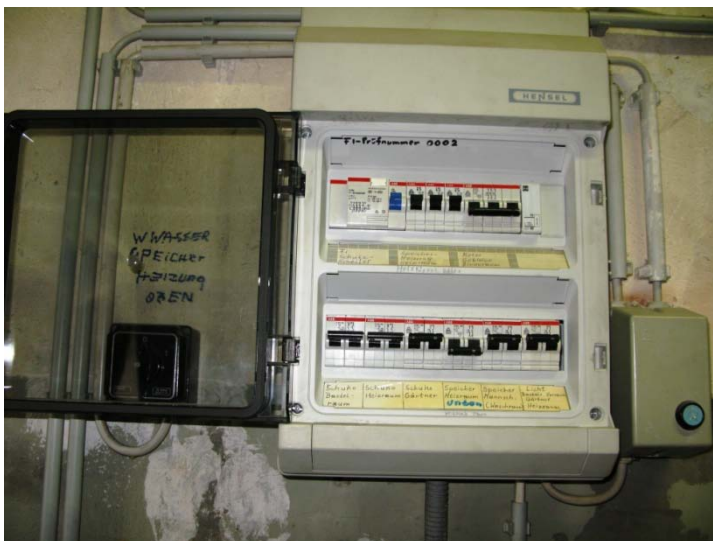
Bild 55 Verteiler Alte Ölheizung
