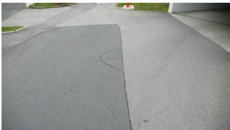
Schlechte Asphaltoberflächen- qualität
