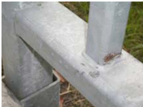
Roststelle bei Brückengeländer
