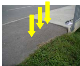
Setzung(srisse) des Gehweges
