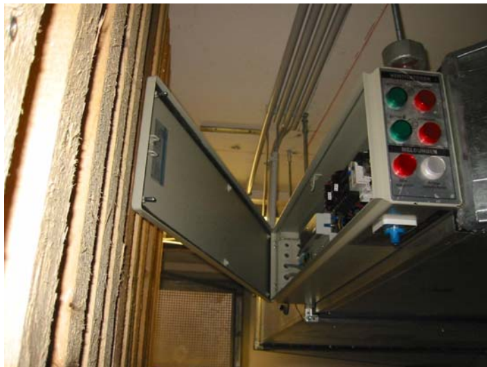
Kombinationsabluftgerät linker Verteiler
