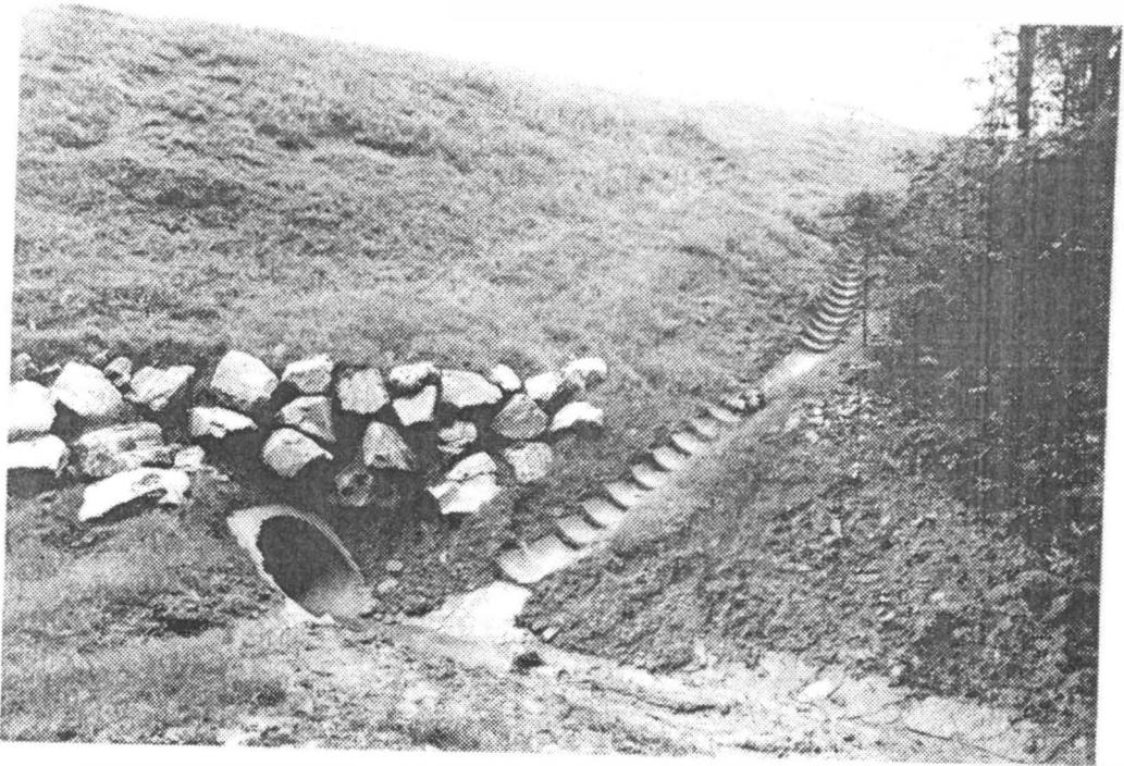
Einlaßöffnung des Durchlasses bei km 4,25 mit schon überhängenden Steinen vor der Vorübernahme und VOR den Regenfällen
