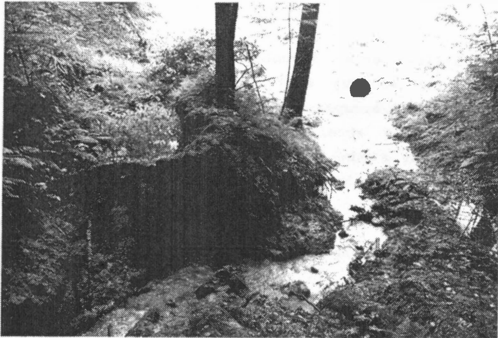
Blick Richtung Durchlaßeinlauf NACH den Regenfällen, mit starken Ausspülungen im Vordergrund
