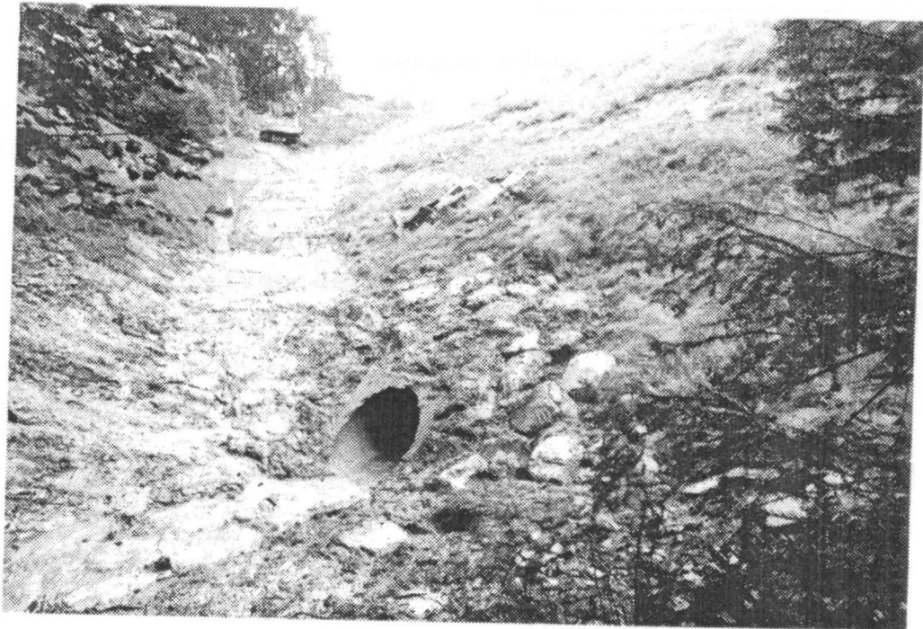
Dieselbe Einlaßöffnung nach der Verlängerung um 2 m mit den durch die Regenfälle darüber entstandenen Böschungsrutschungen.
